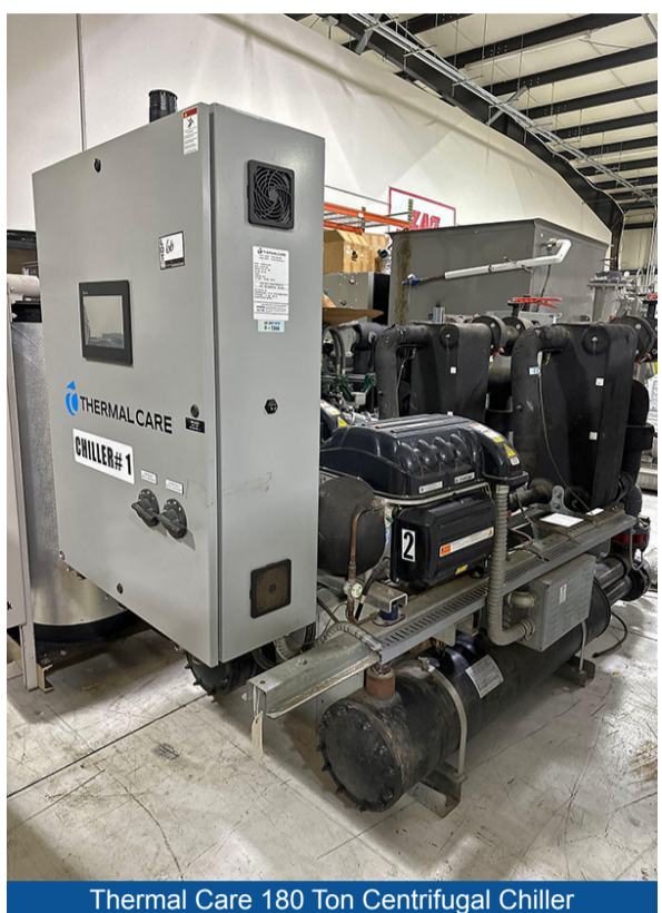
Thermal Care 180 Ton Centrifugal Chiller
